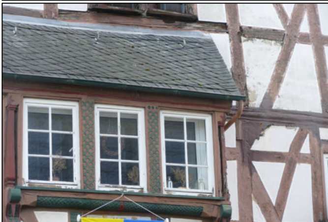
Sanierungsbedarf Fachwerk Ortsmitte
